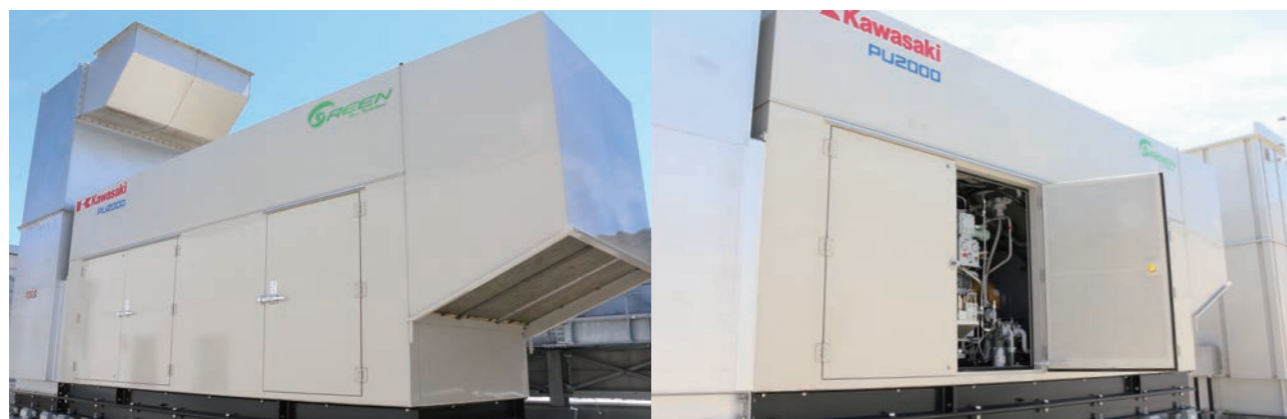
自家発電装置
